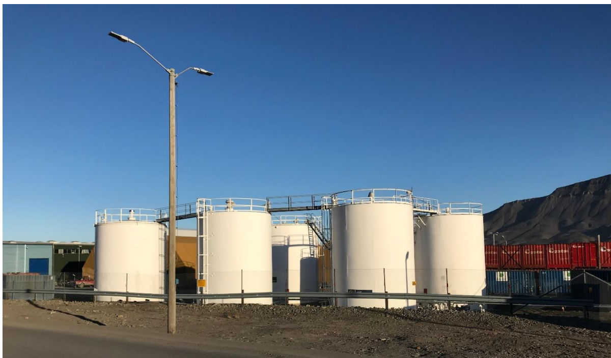
Tankanlegg for bensin i Sjøområdet, Longyearbyen. Største tank er 300 \text{ m}^3
